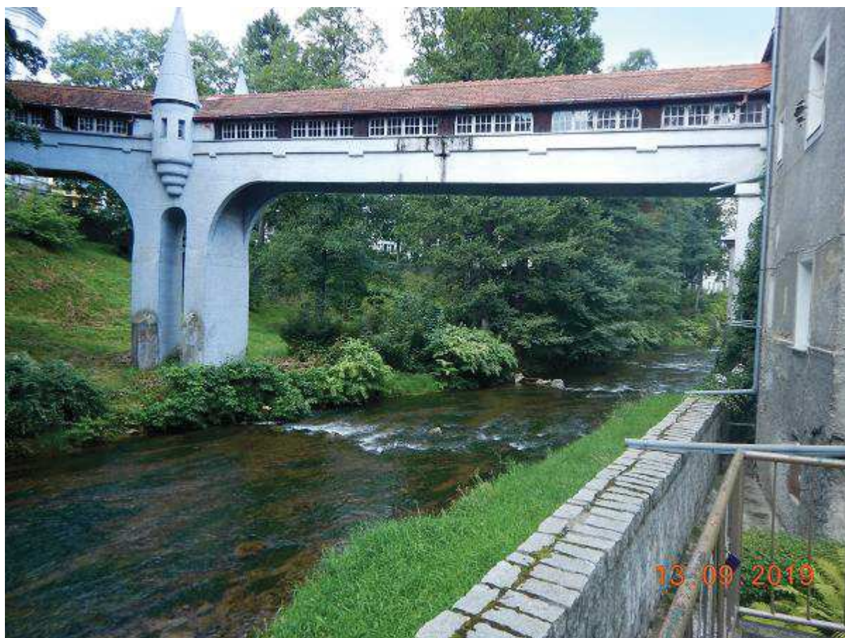
Fot. 68 Most M-29 w km 24+500 widok od górnej wody. Brak działai
