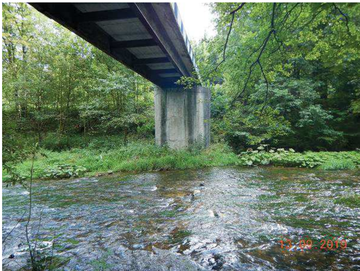
Fot. 80 Most M-31 w km 25+261. Widok na brzeg prawy - brak działań
