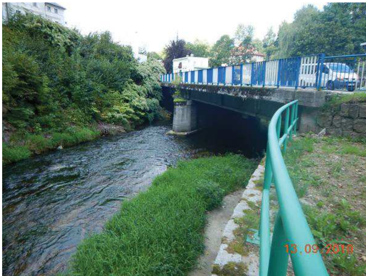
Fot. 66. C.d. Widok mostu M-28 od wody górnej w km 24+386. Udrożnienie światła i wzmocnienie umocnień dennych filara i przyczółków
