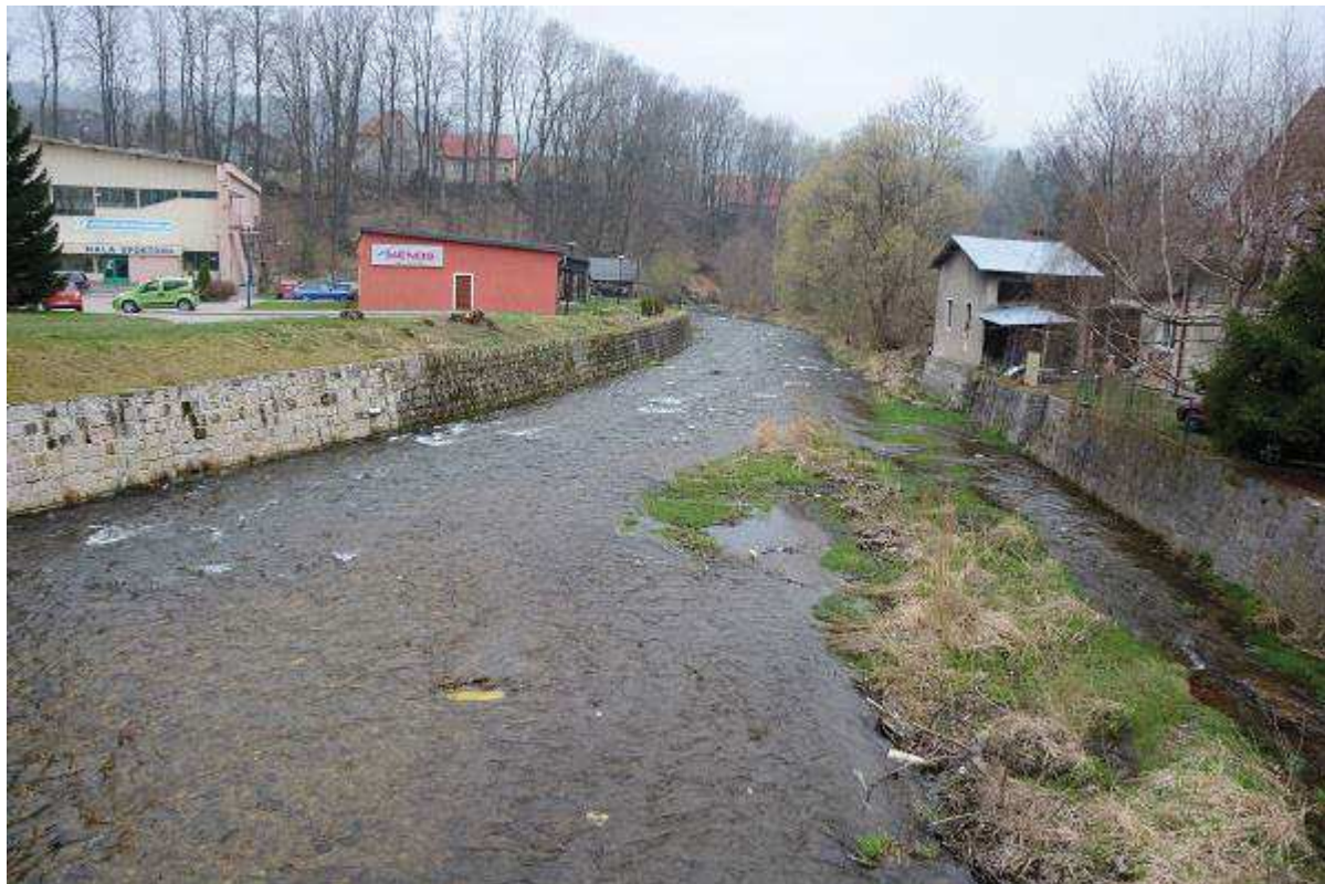
Fot. 3 Reprofilacja muru lewobrzeżnego poniżej mostu M-38 na odc. km 30+585 ÷ 30+732 [widok koryta od DW mostu M-38] oraz brzegowy mur prawobrzeżny do reprofilacji poniżej mostu M-38 na odc. km 30+680 ÷ 30+732 (do mostu dr. M-38)
