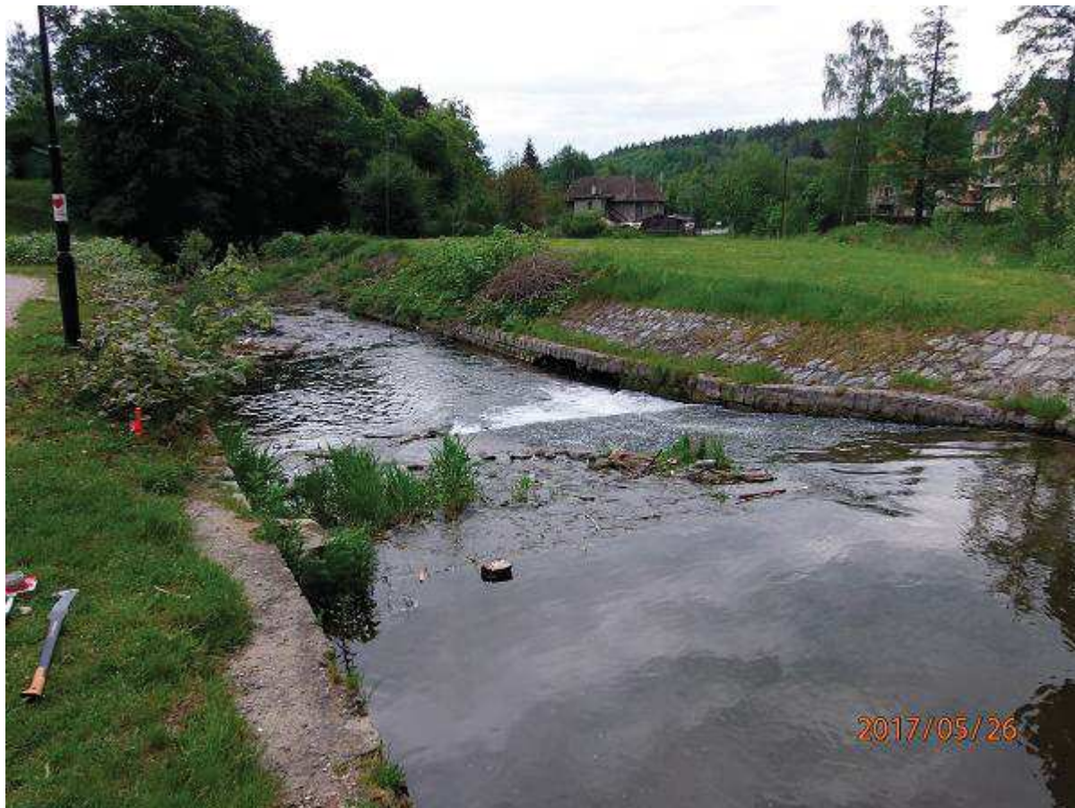
Fot. 24- Dolne stanowisko poniżej progu w km 15+498 do remontu
