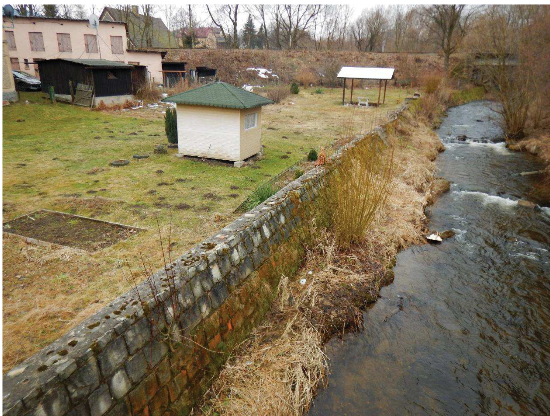
Fot. 11. Reprofilacja muru w km 22+110 ÷ 22+155 (BP).
