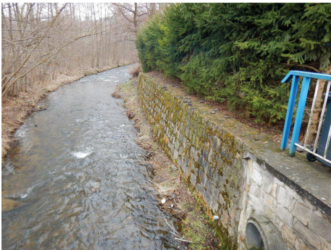
Fot. 17. Reprofilacja muru w km 22+405 ÷ 22+450 (BP).
