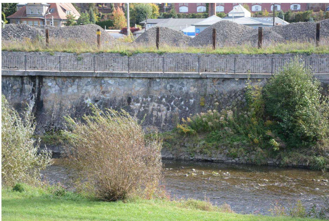
Fot. 22. Reprofilacja muru w km 130+625 ÷ 130+750 (BP).
