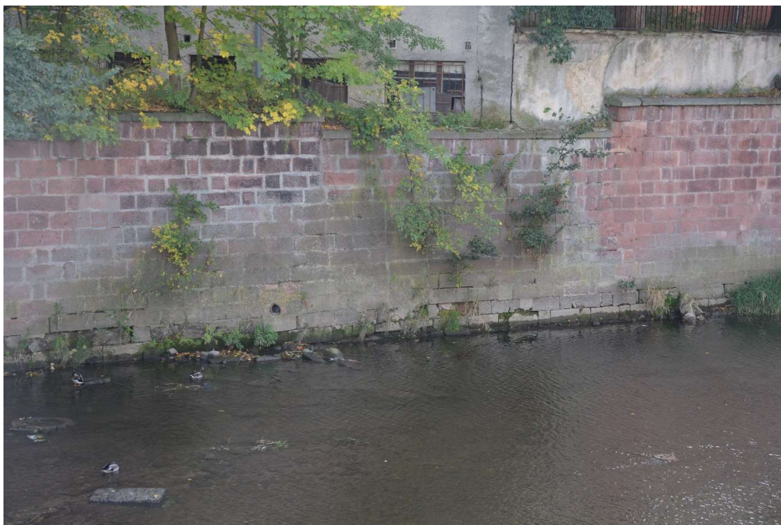
Fot. 11. Reprofilacja muru w km 129+890÷ 130+220 (BP).
